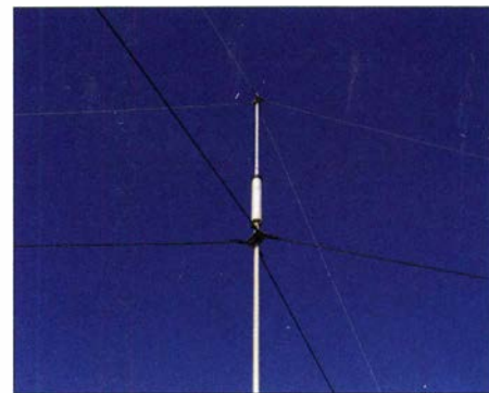
Mehrband-Groundplane-Antenne einschließlich Abspannseilen auf dem Dach
